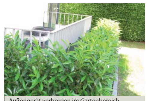
Außengerät verborgen im Gartenbereich
